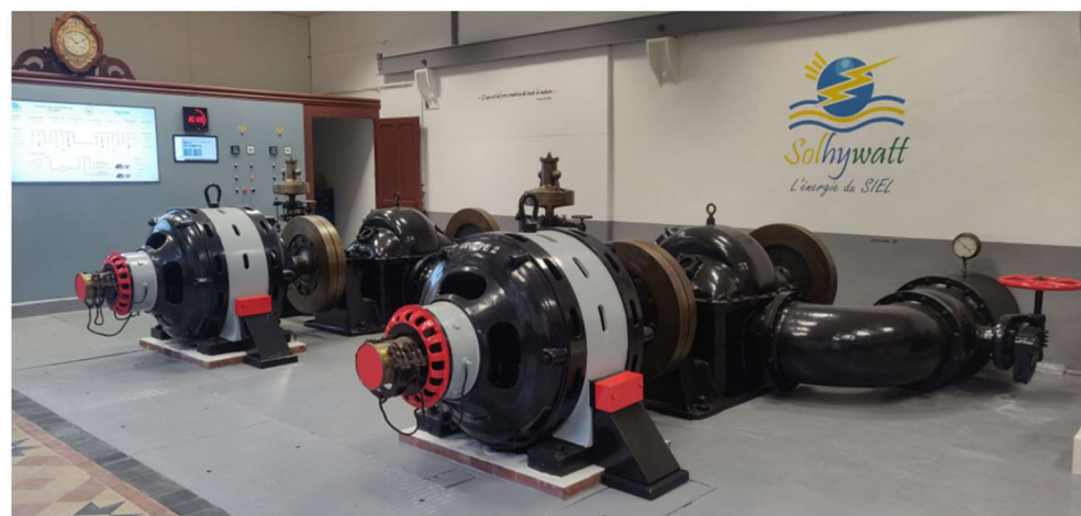
Turbines Francis sous 25 m de chute - Centrale du Fourpéret (25).
